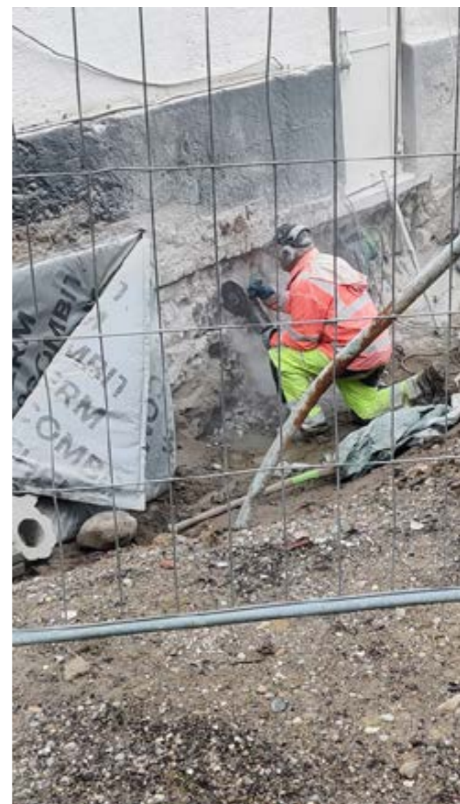
Oprensning efter olieforureningen er et større projekt
